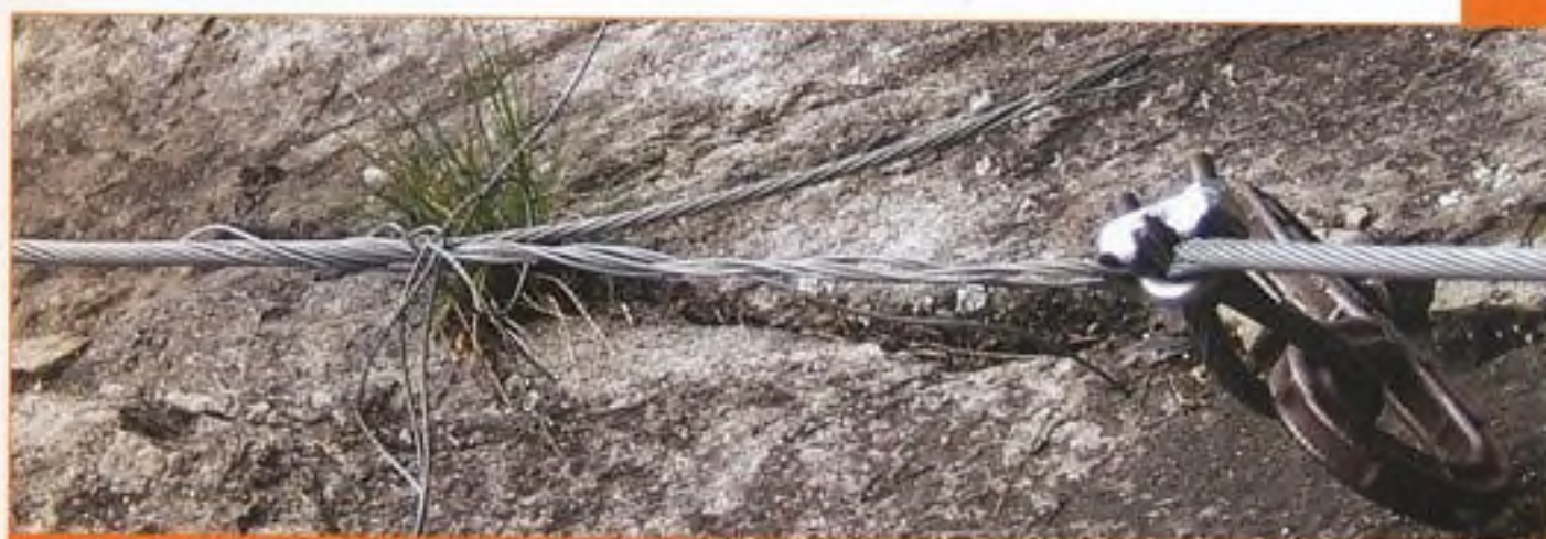
Die Drahtseile sind nicht immer in optimalem Zustand.
